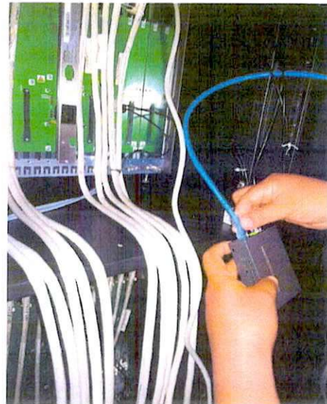
Gambar 3.5. Instalasi Converter LAN
